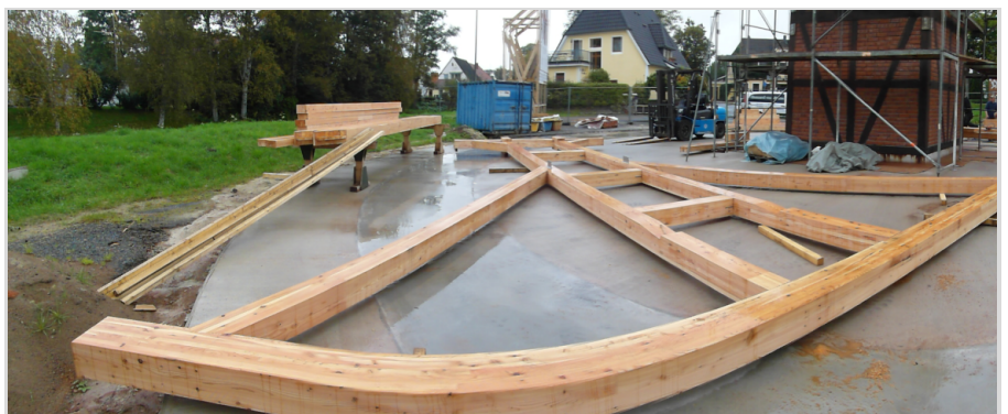
Abb. 5: Hiobsbotschaft bei Tag: Der Trimbalken ist verbogen und kann so nicht mehr eingebaut werden.
