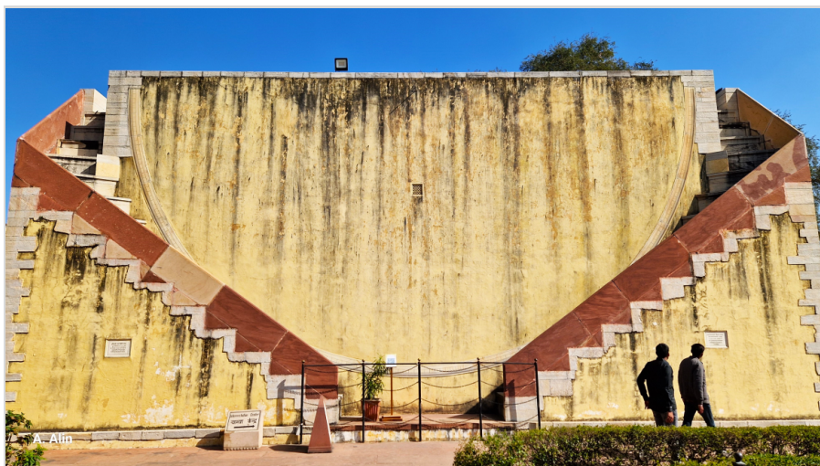
Abb. 10: Das Daksinottara Bhatti Yantra. Die Wand bräuchte dringend eine Reinigung und einen neuen Anstrich. Dann könnte man auch die bogenförmige Skala erkennen.
